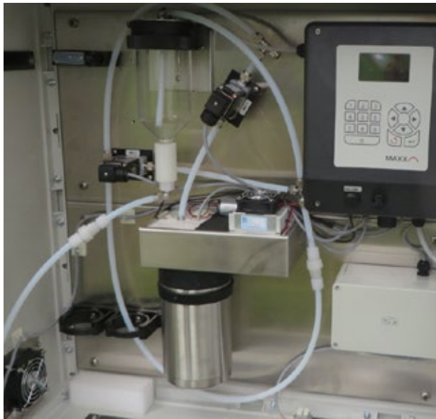
Abbildung 1: Innenansicht des automatischen Probensammlers (Foto: Liana Liebmann)
